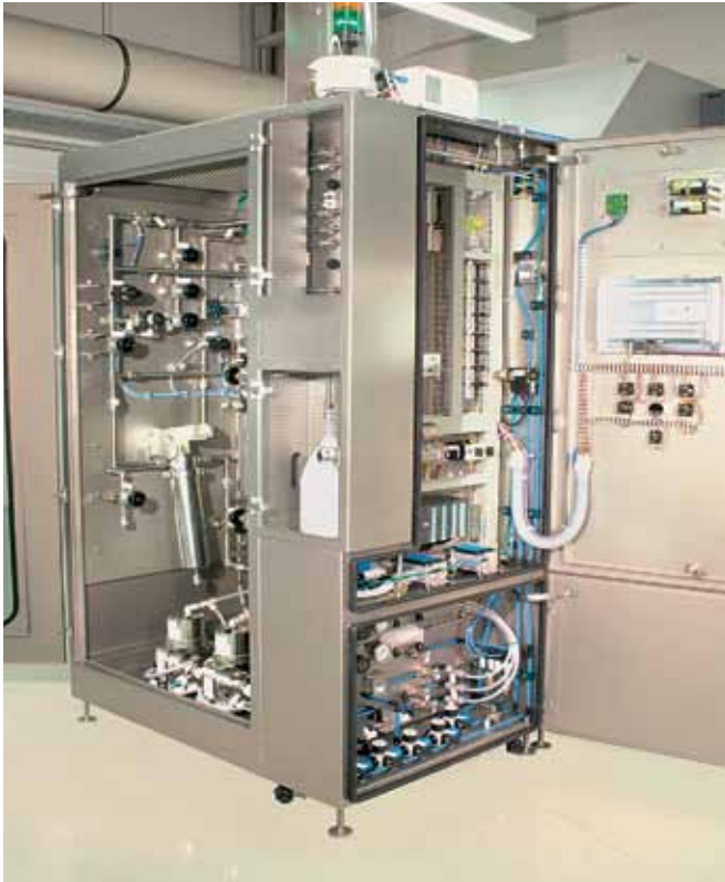
Модуль системы подачи растворителей Module for supplying solvents
